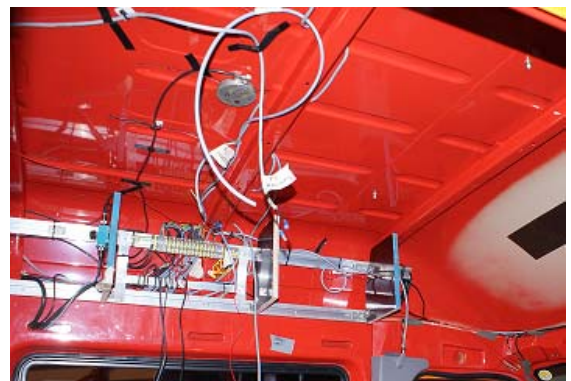
Alle kabels komen bij elkaar
